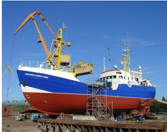
FS „Professor Albrecht Penck“ zu Reparaturarbeiten in der Peene-Werft in Wolgast im Jahre 2007 (Foto: J. RUICKOLDT/IOW).
