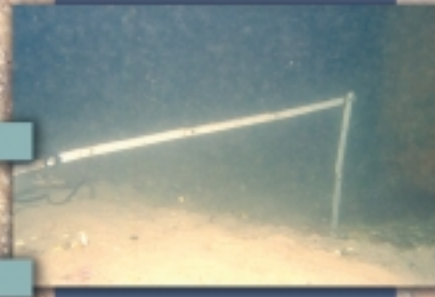
Abb. 2: Auskolkung am Stahlrohr
